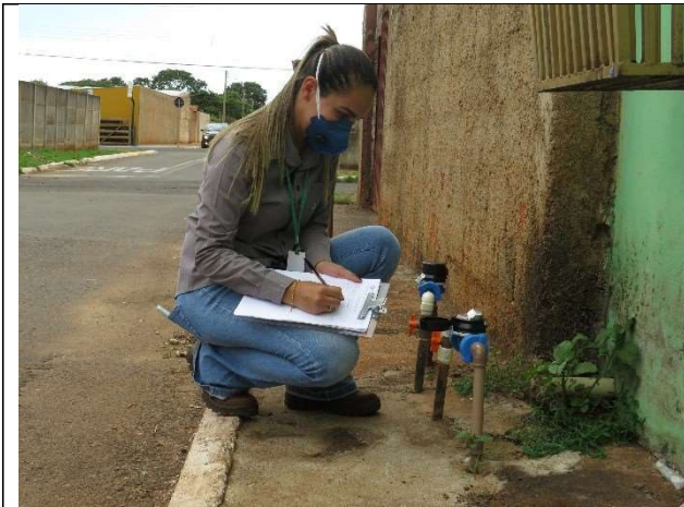
Autor: AMAE Descrição: Equipe da AMAE realizando a conferência de hidrômetros instalados.
