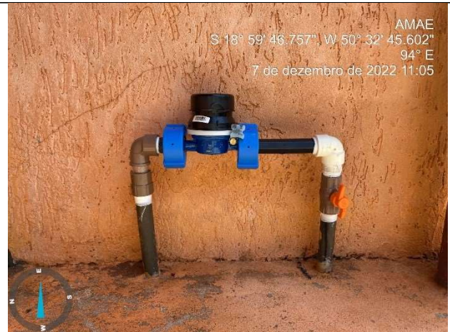
Autor: AMAE Descrição: Hidrômetro instalado, nivelado e com lacre, apto para iniciar o faturamento.
