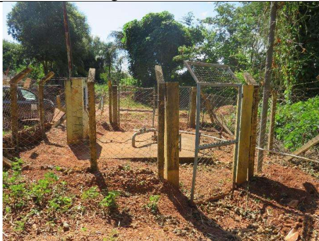
Autor: AMAE Descrição: Identificação de poço 03 Colombo com derivação.
