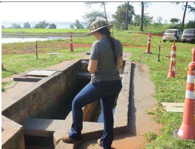
Autor: AMAE Descrição: Avaliação das caixas de areia.
