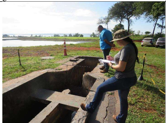
Autor: AMAE Descrição: Calha Parshall sem medição.
