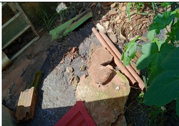
Autor: Reclamante Descrição: Marcas de transbordamento de esgoto na residência da reclamante, datada 21/01/2023.
